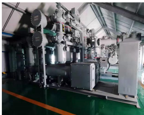
图 4-9 220kV 配电装置
