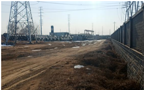
图 4-3 220kV 汇河站东侧
