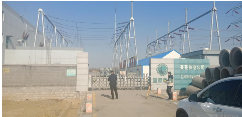
图 4-2 220kV 汇河站全景图
