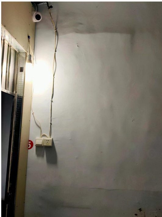
探伤机贮存室室内监控
