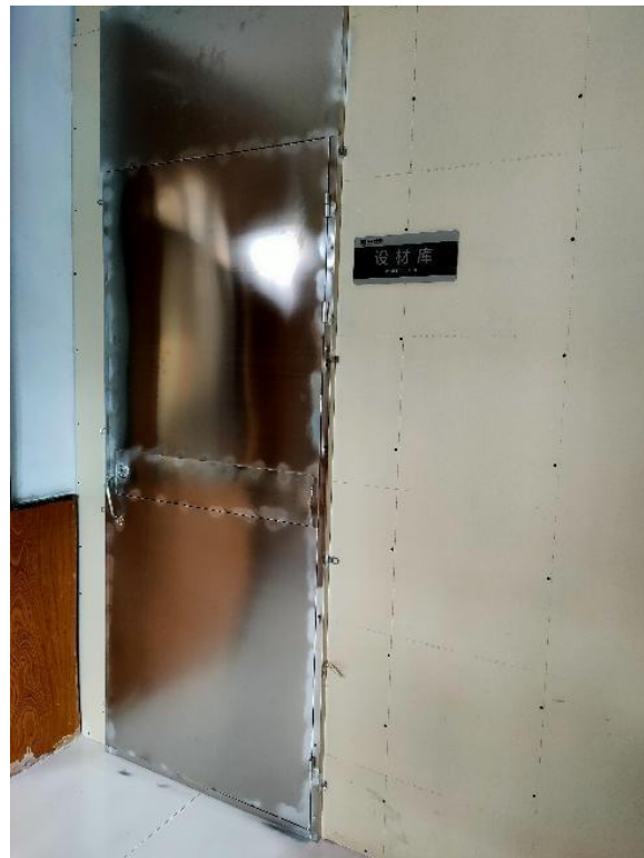
探伤机贮存室防盗门
