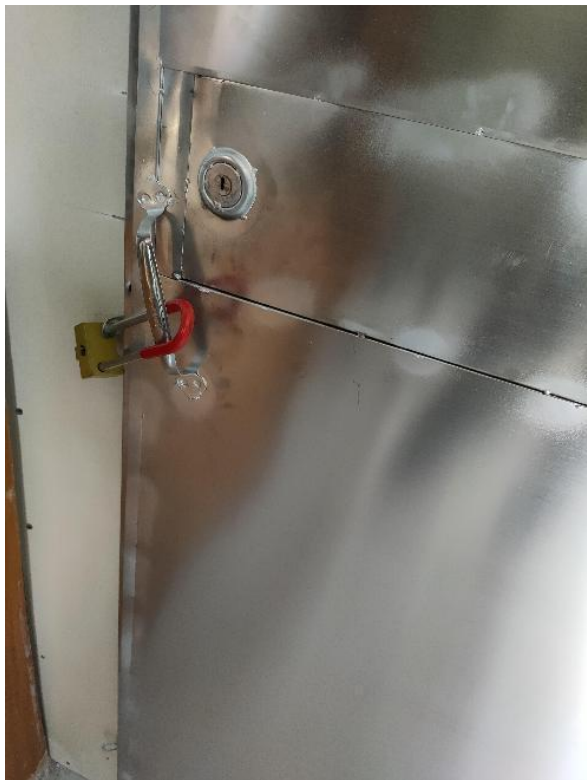
探伤机贮存室双人双锁
