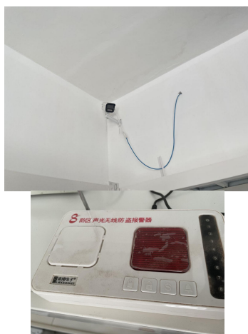
监控装置、入侵报警装置
