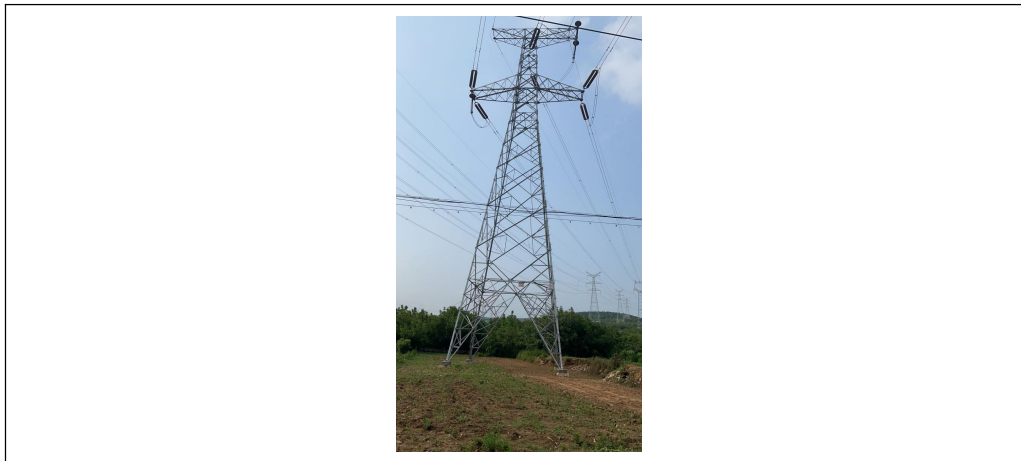
图 4-1 220kV 输电线路周围现场照片
