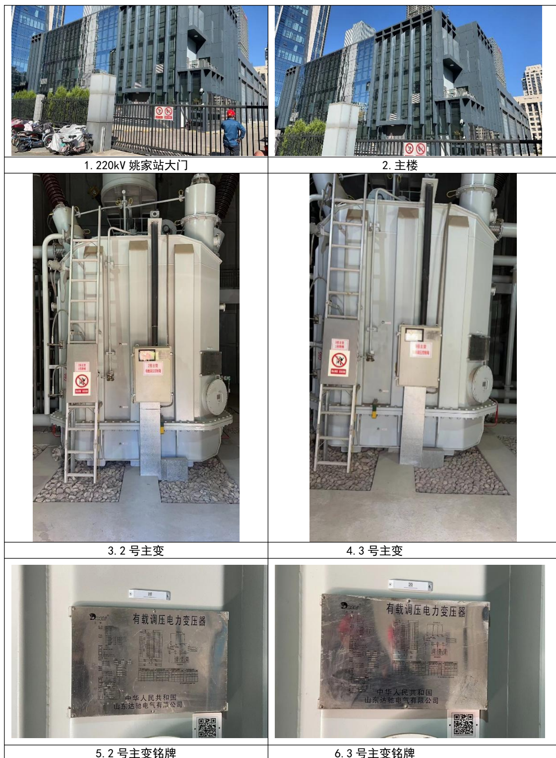
图 4-5 220kV 姚家站内现场照片
