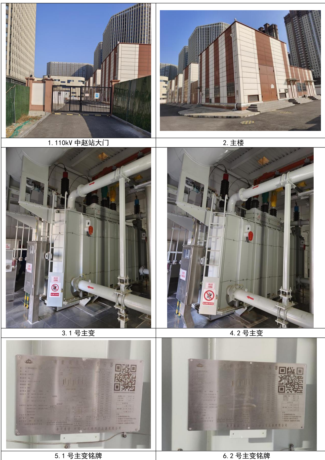
图 4-5 110kV 中赵站内现场照片
