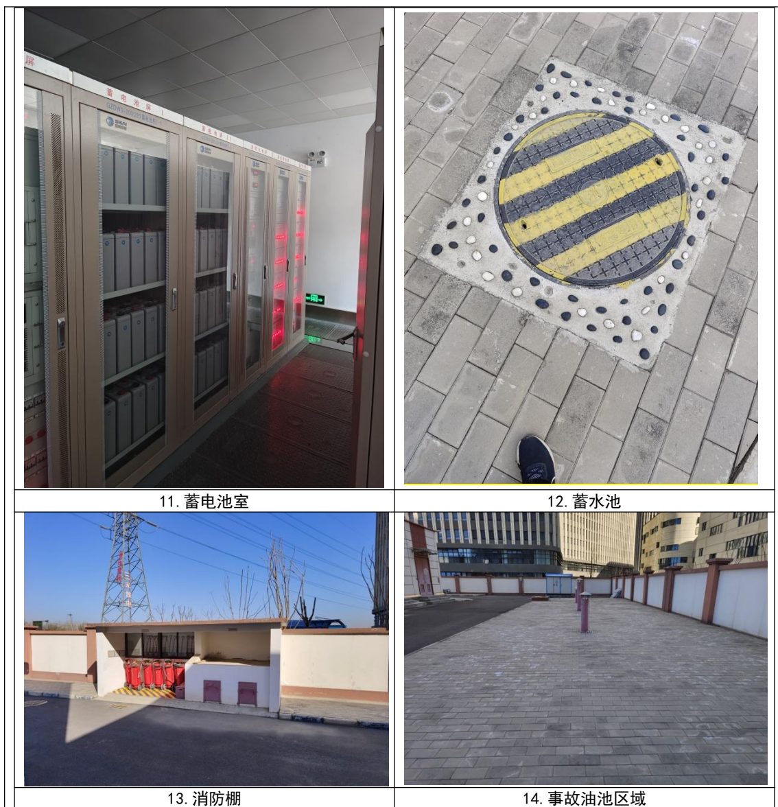
图 4-5（续） 110kV 中赵站内现场照片
