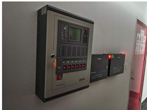
9. SF 6 气体泄漏报警装置
