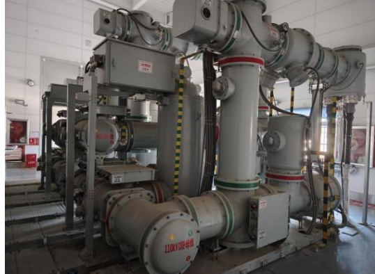
8. 110kV 配电装置
