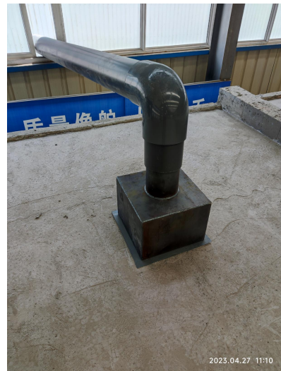
通风管道及铅防护罩
