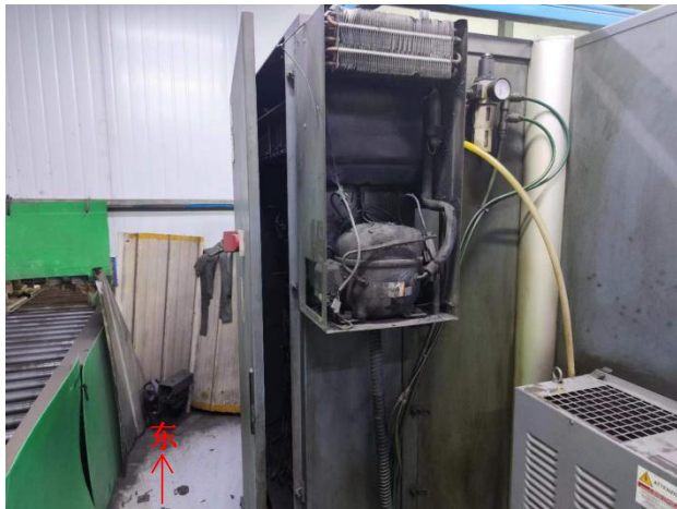
X 射线实时成像检测系统北侧现状
