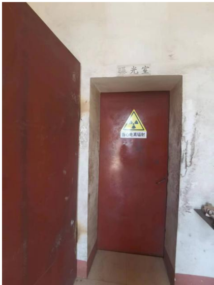
探伤室小防护门
