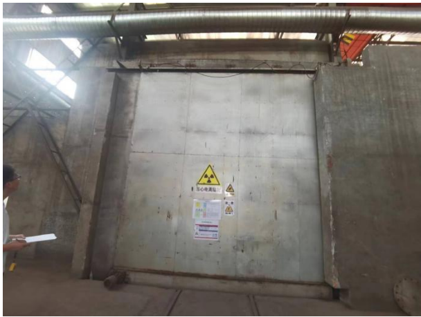
探伤室大防护门
