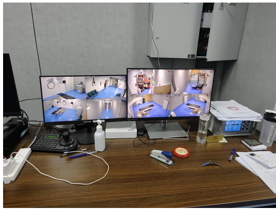
控制室内电视监控
