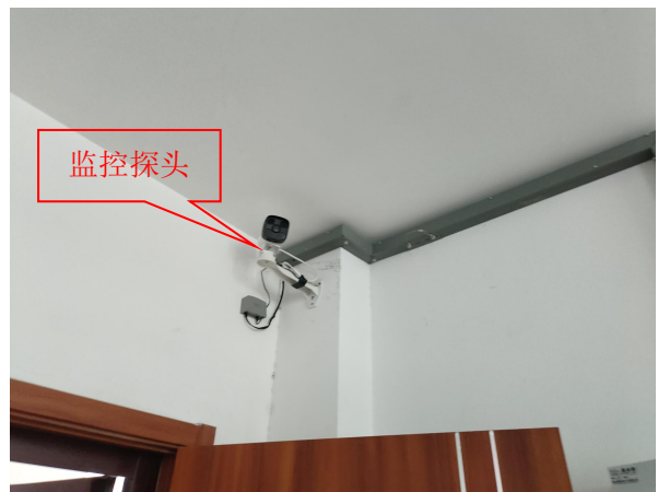
设备间内监控探头
