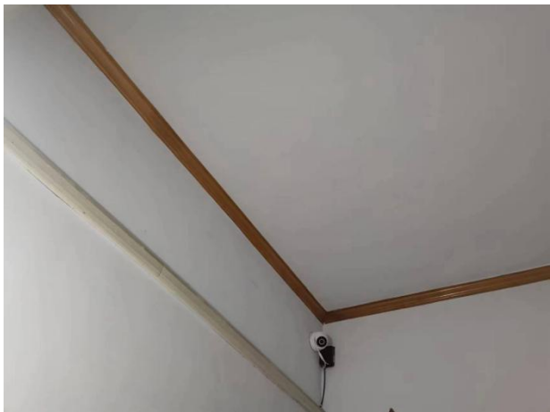
设备间内监控
