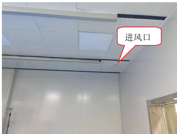
进风口（手术室室顶）
