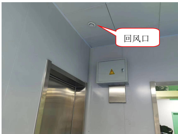
回风口（手术室室顶）
