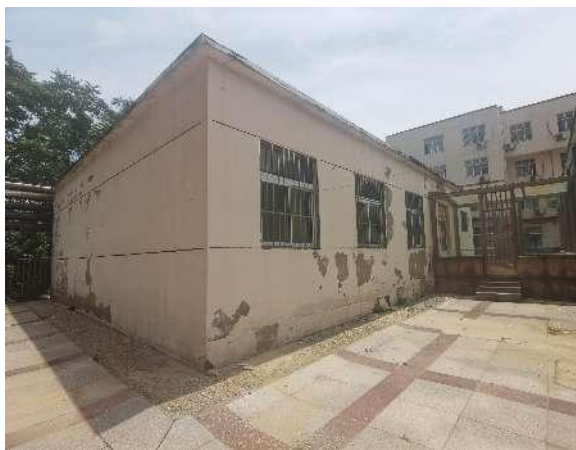
南侧高压氧舱室
