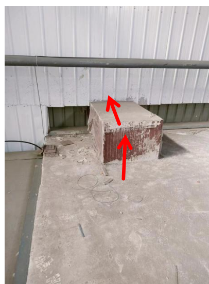
通风口外侧通风管道
