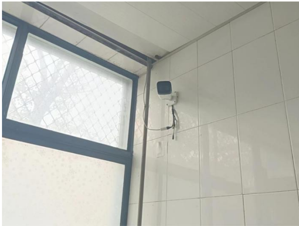
设备间内监控
