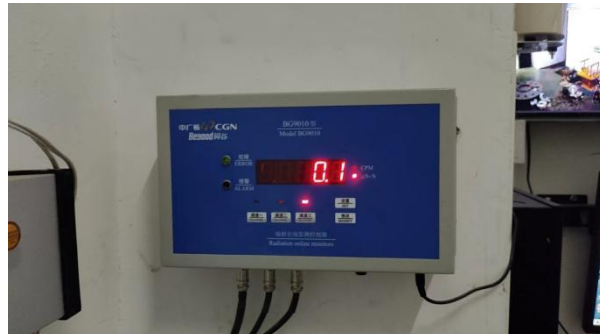
在线监测仪（操作室内控制器）
