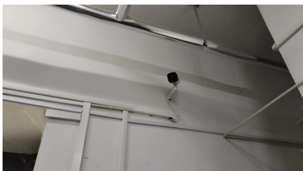
监控装置（曝光室室顶东北角）
