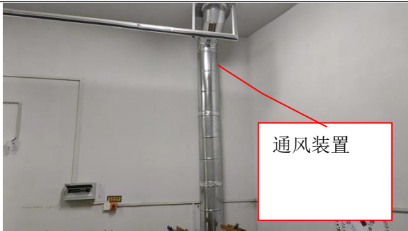
曝光室内通风装置
