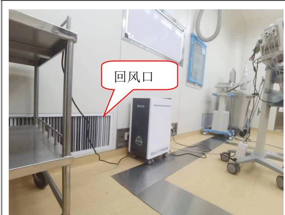
回风口（手术室东西墙下方）
