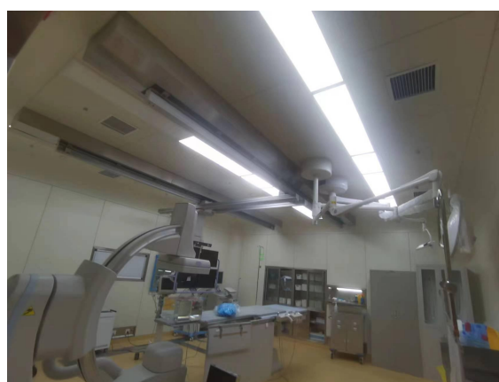
进风口（手术室室顶）
