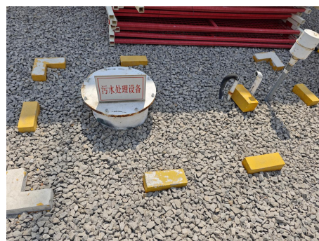
施工人员站内生活污水处理设施 (依托前期)
