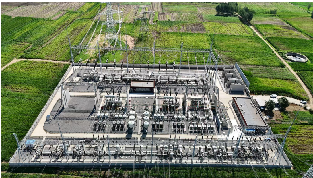
图 3.1-2 岱宗 500 千伏变电站俯瞰图
