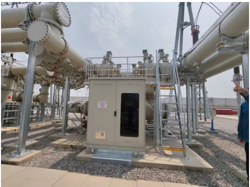
500kV 出线间隔 1
