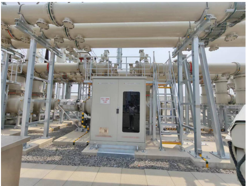
500kV 出线间隔 2
