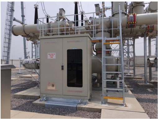
500kV 出线间隔 3
