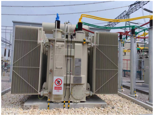
35kV 低压电抗器
