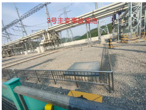
#3 主变事故油池
