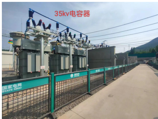
35kV 电容器（2 组）
