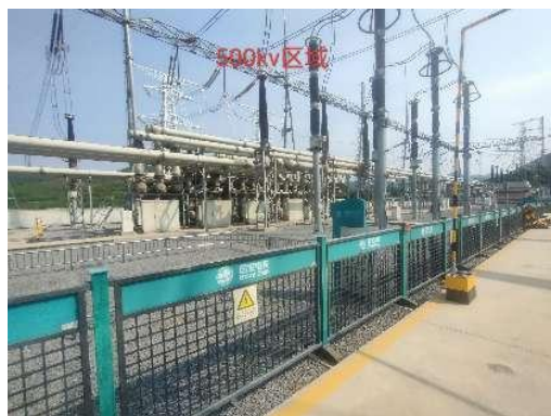
500kV 配电装置区域
