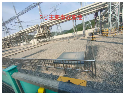
#3 主变事故油池
