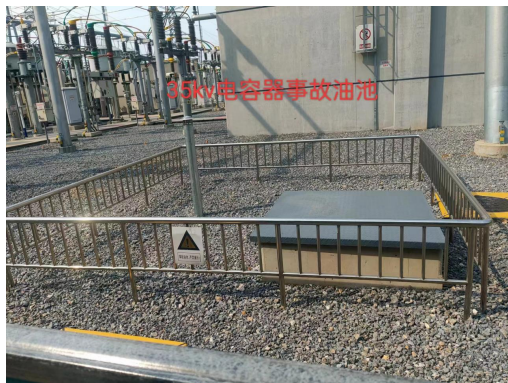
35kV 电容、电抗器事故油池
