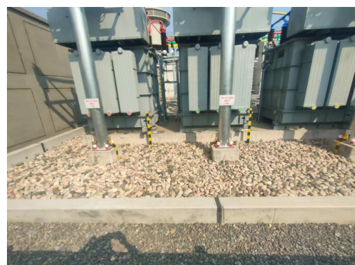
35kV#3A 电容器贮油坑
