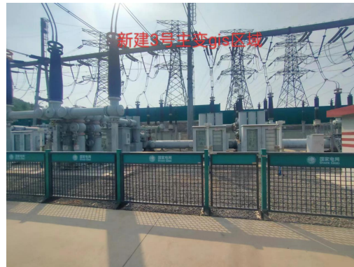
220kV 配电装置区域
