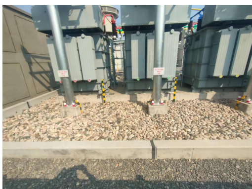
35kV 电容器贮油坑（同等规格 2 个）
