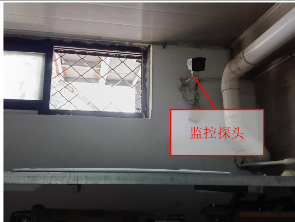
设备库内监控
