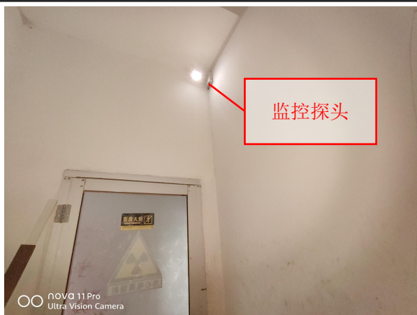
贮源库内监控探头
