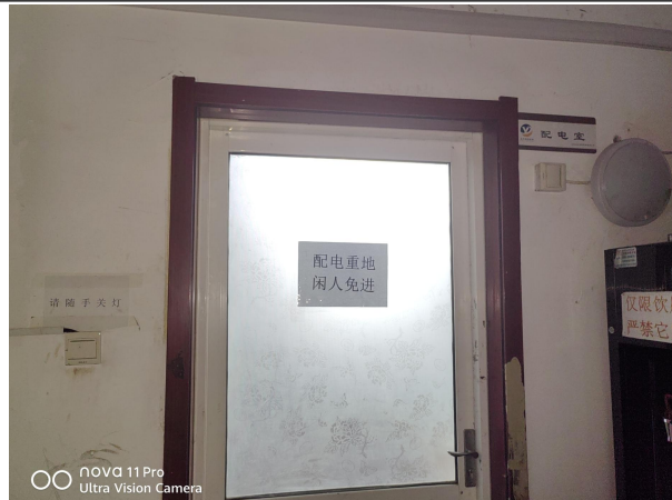
贮源库北侧配电室
