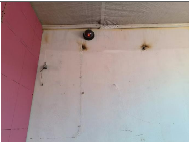
设备间内监控
