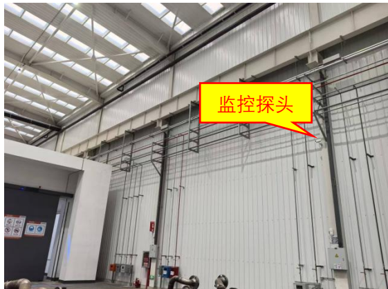
探伤室外西侧监控
