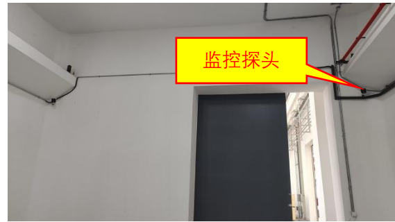
探伤室内东侧监控
