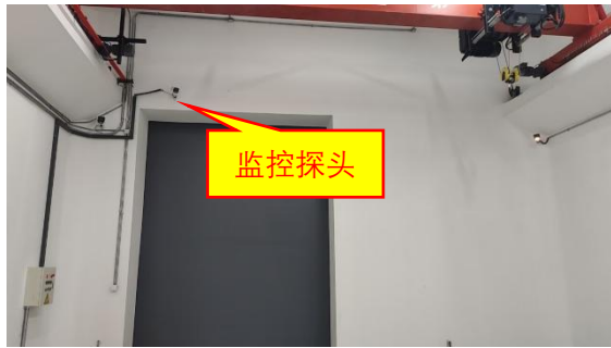
探伤室内西侧监控
