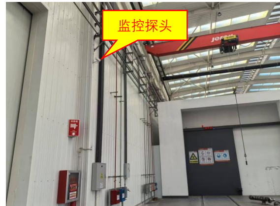
探伤室外东侧监控
