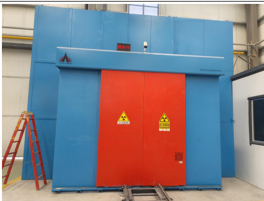
图 2-3 本项目 X 射线实时成像检测系统设备外观
