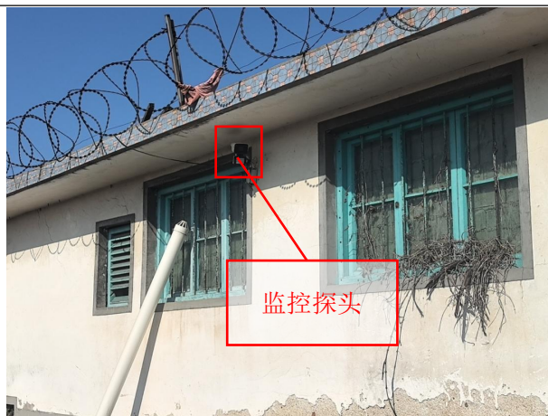
院外南墙监控探头
