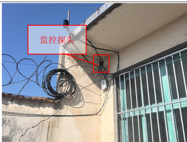
院内西北角监控探头
