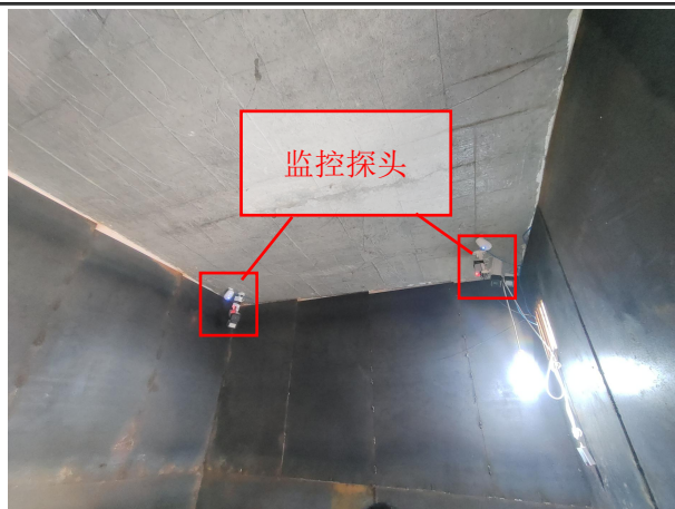
贮源库内监控探头
