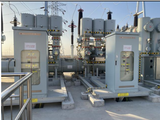
220kV 配电装置
