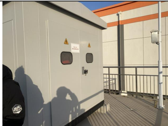
35kV 配电装置
