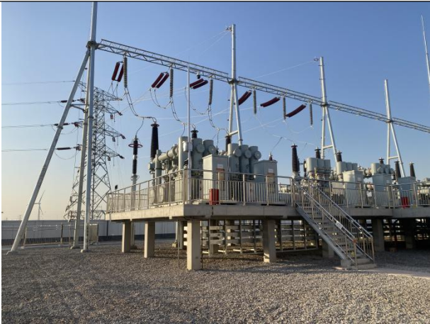
220kV 出线间隔
