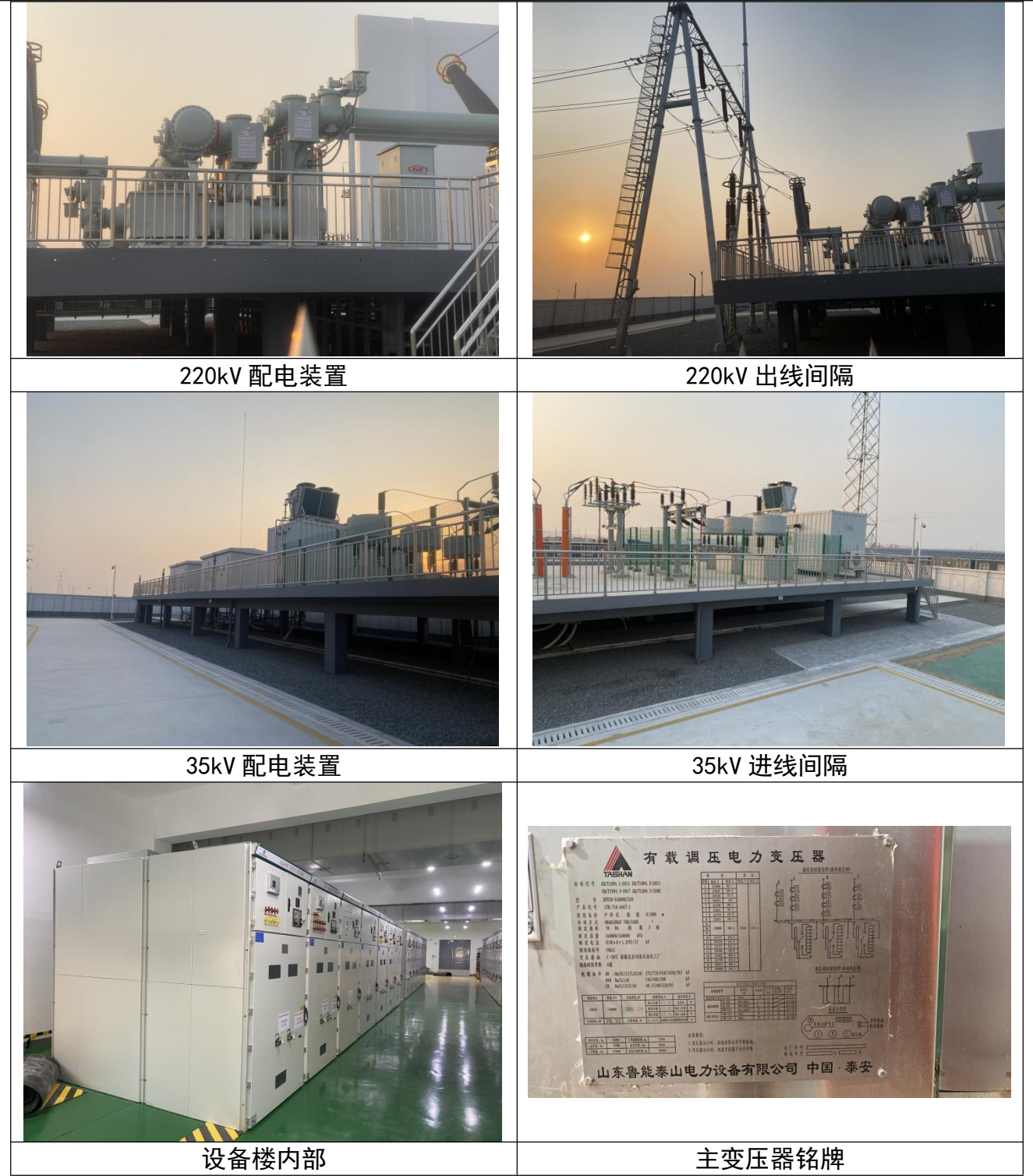
图 4-2 升压站内现场照片 (拍摄于 2025 年 1 月)
