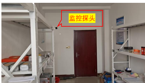
设备间内监控
