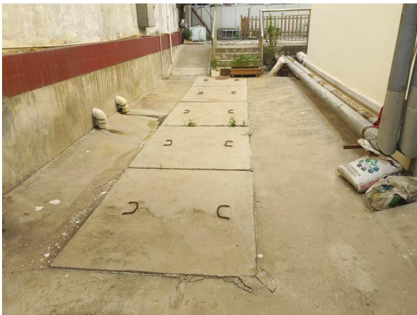
图 3-2 本项目衰变池现状
