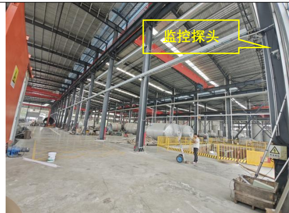
大防护门外监控探头
