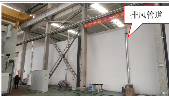
曝光室北墙外 3 个排风管道
