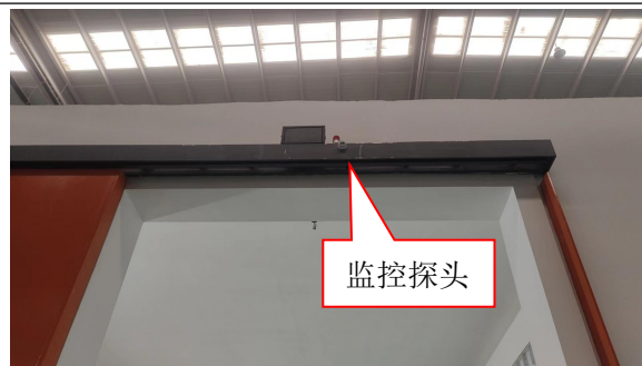
西侧大防护门上方监控探头
