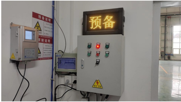
操作室内门控开关
