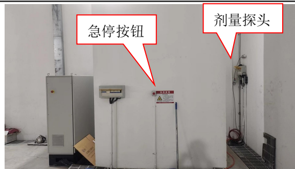
迷道处急停按钮和辐射剂量检测仪探头
