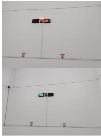
探伤室工作状态指示灯
