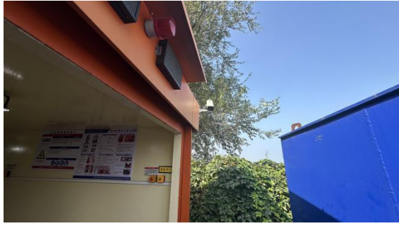
防护门外监控
