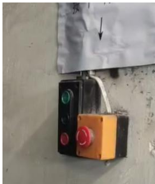
探伤室内门控开关
