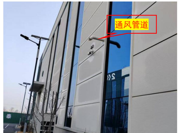
1#车间西墙外通风管道
