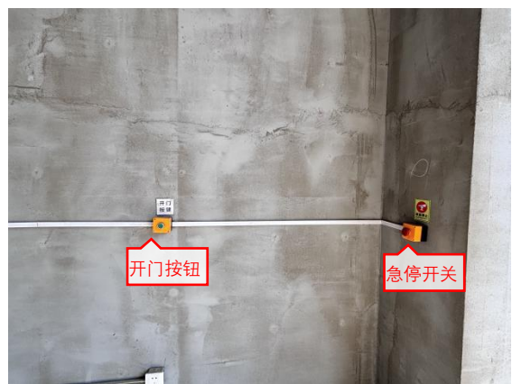
探伤室内开门按钮和急停开关
