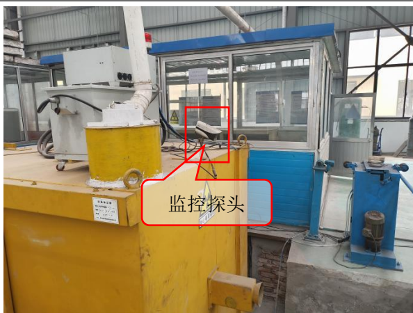
X 射线实时成像检测系统 室顶防护面西侧监控探头
