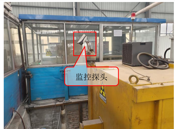
X 射线实时成像检测系统 室顶防护面东侧监控探头
