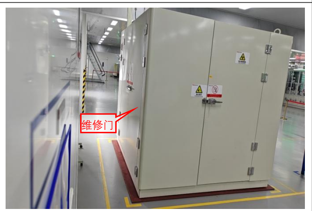
5#工业CT机辐射屏蔽室西侧 (L2161型)
