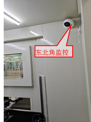
5#工业CT机辐射屏蔽室内部 (L2161型)
