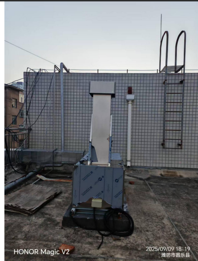
排风管道终排口
