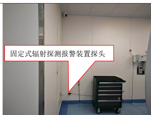
固定式辐射探测报警装置剂量探头
