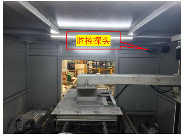
1#铅房西内东南角监控探头
