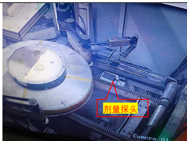
1#铅房内固定式辐射报警装置剂量探头
