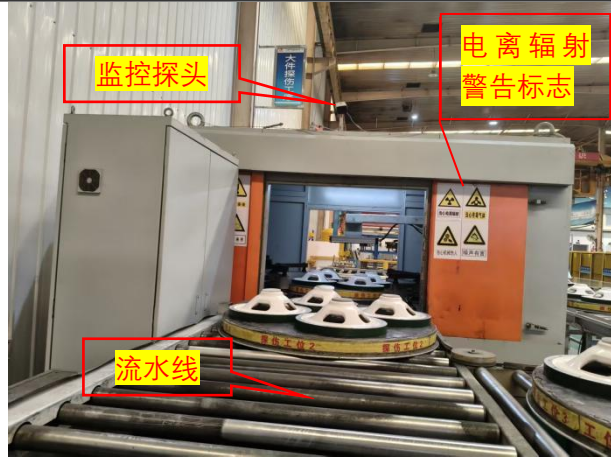
1#铅房西侧防护门
