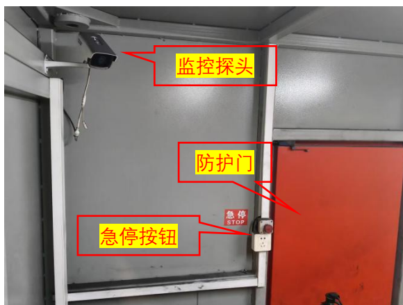
1#铅房西内西北角上监控探头、急停按钮
