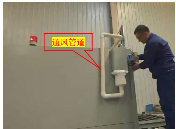
1#铅房通风口及通风管道
