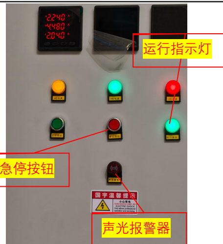
配电柜自带操作按键及指示灯、报警器
