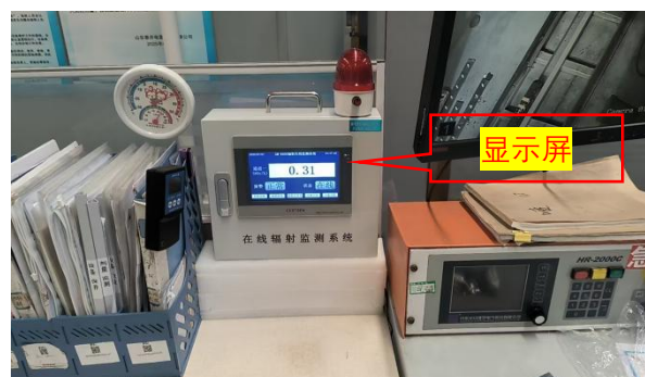
操作位处固定式辐射报警装置显示屏
