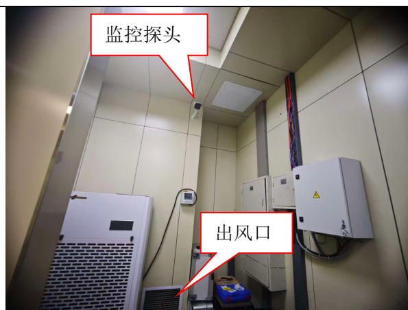
设备区监控探头、出风口
