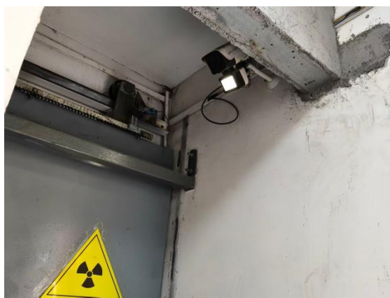
小防护门外监控
