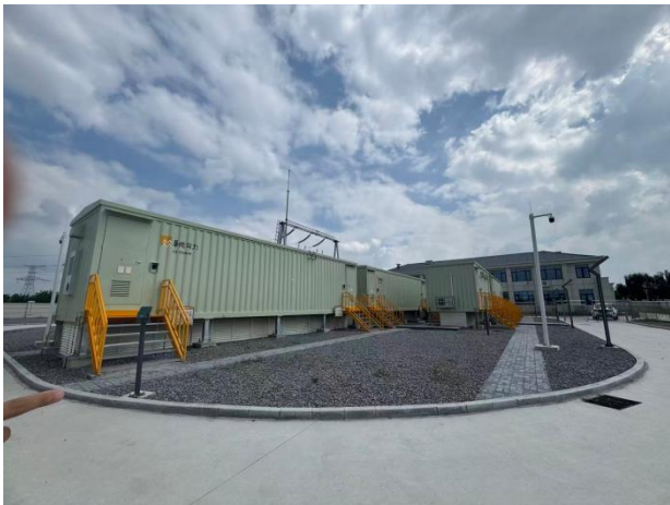
35kV 配电装置预制舱
