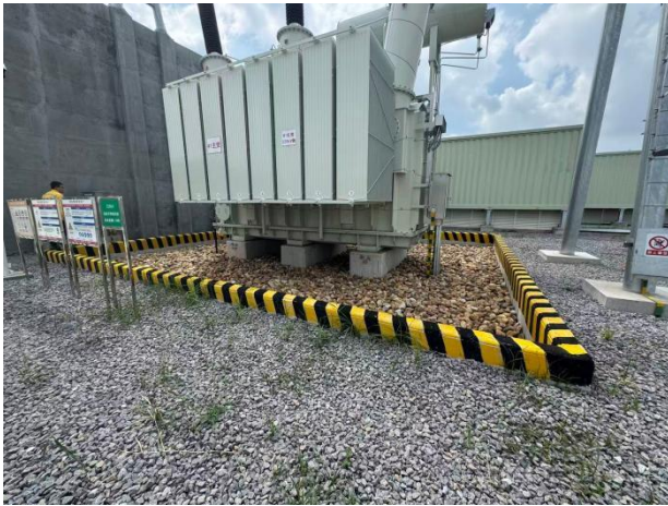
主变下贮油坑
