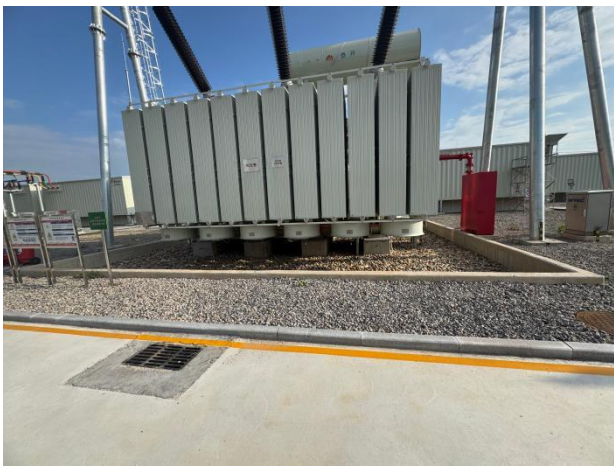
主变下贮油坑
