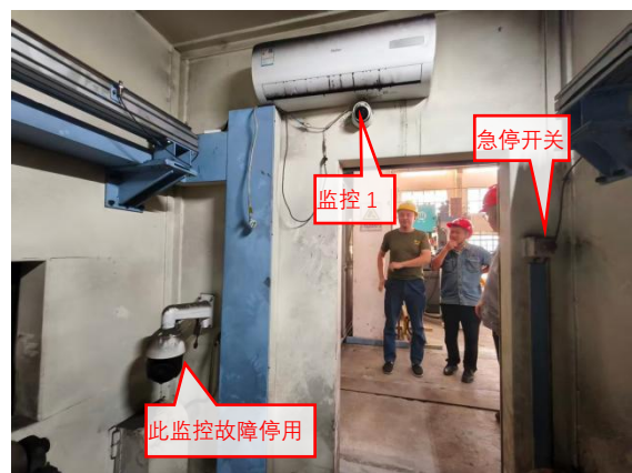
X射线实时成像检测系统南侧
