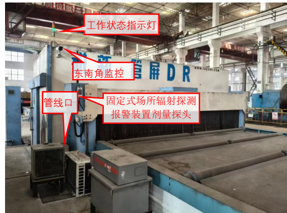
X射线实时成像检测系统东侧
