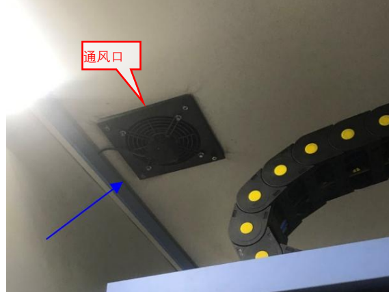
X射线实时成像检测系统内通风口
